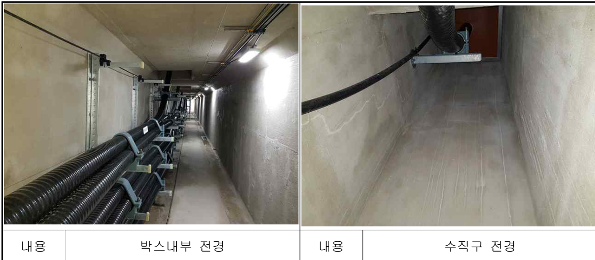
【사진 2.1】 포천인출 전력구 현황
